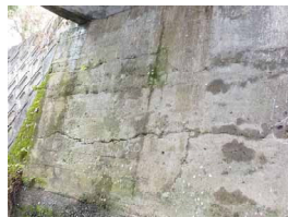
損傷：ひびわれ
