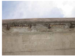
損傷：鉄筋露出
