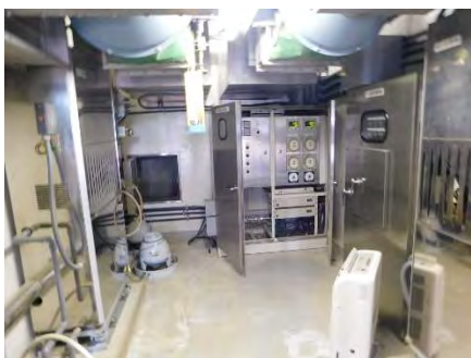
図 3-8：保存施設機械室
