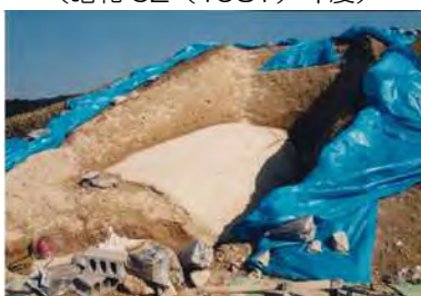
図 2-97：防水層の亀裂(平成 12 (2000) 年度)
